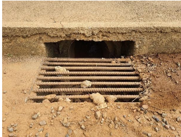
Figura 16 - Presença de sedimentos provenientes de arraste de materiais de construção de residências próximas.
