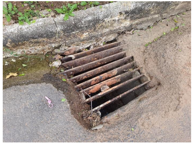
Figura 15 – Presença de boca de leão devidamente instalada, porém não atende a necessidade do local.
