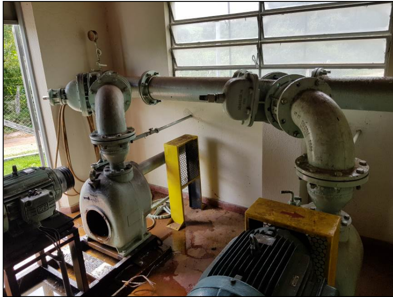
Foto 2 - Vista interna da EEAB 1
