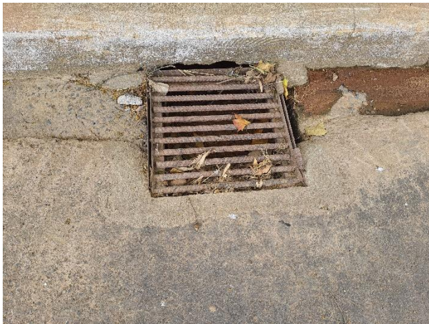
Figura 14 – Presença de boca de leão devidamente instalada, porém não atende a necessidade do local.
