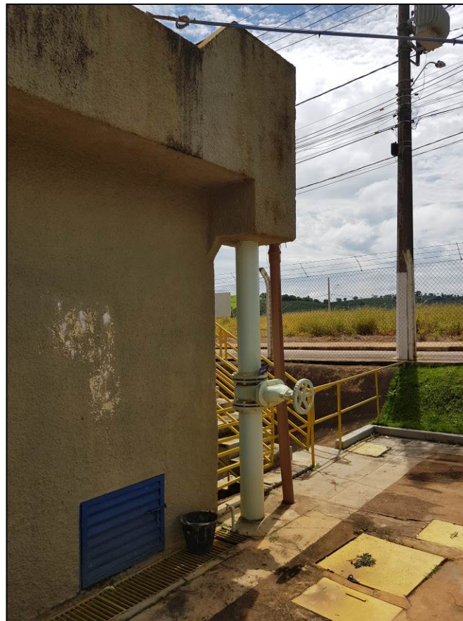
Foto 9 - ETA - Botelhos - Entrada da adutora de água bruta - AAB
