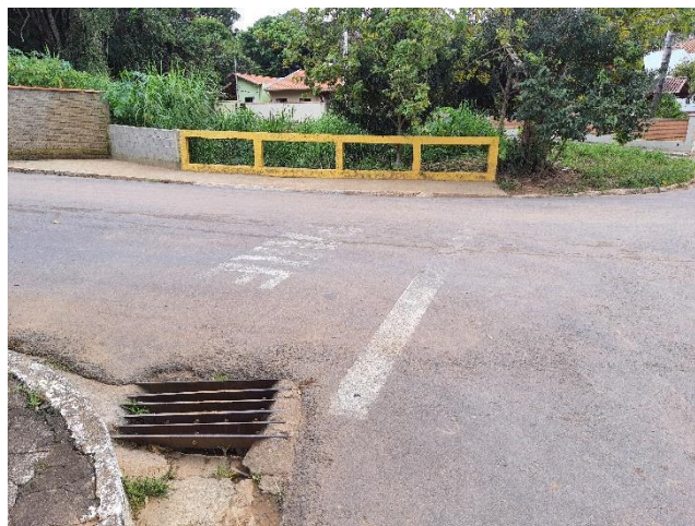
Figura 11 - Dispositivo instalado - subdimensionado
