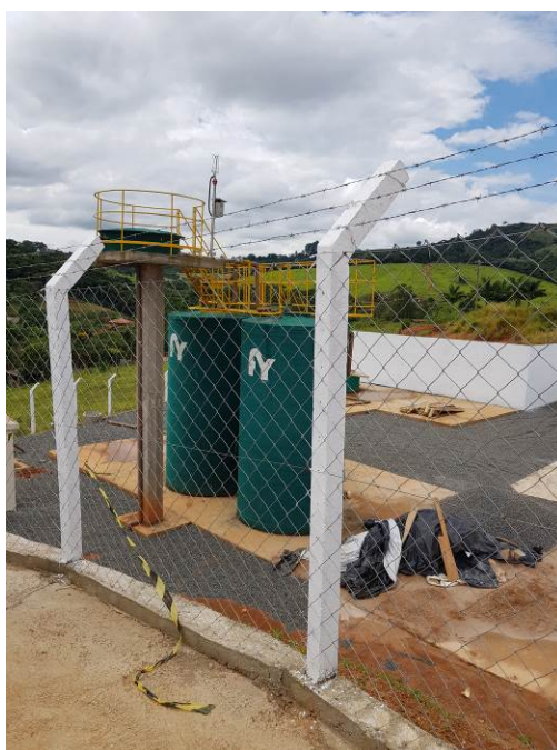
Foto 43 - Botelhos - ETE compacta em implantação em loteamento recente
