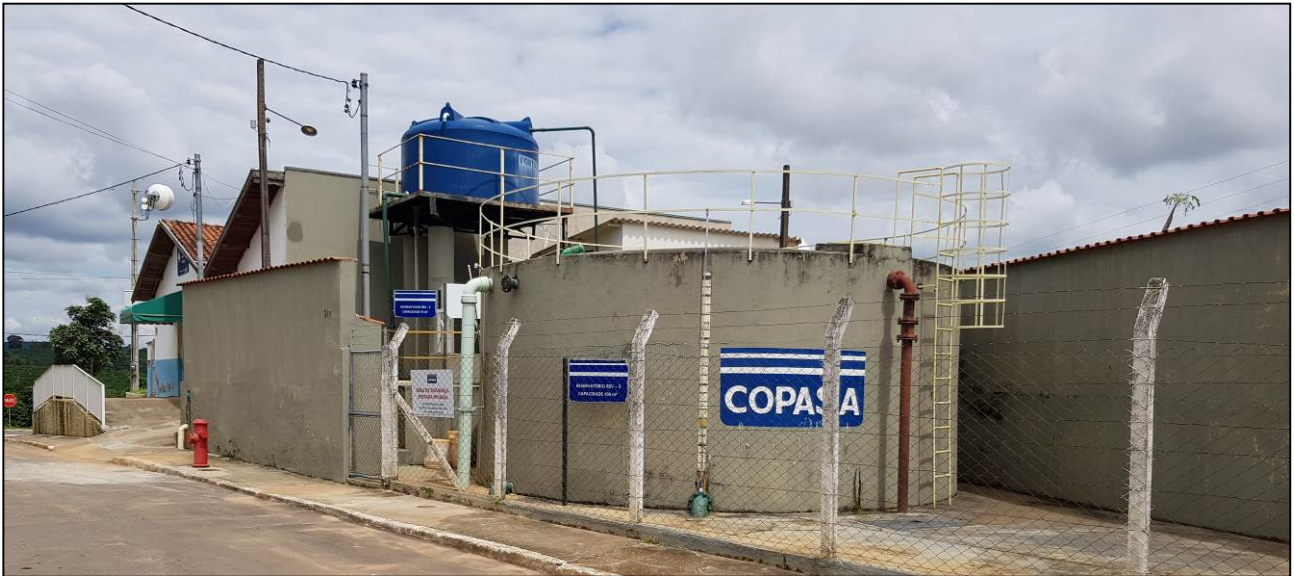
Foto 34 - Centro de reservação - RAP III e REL I
