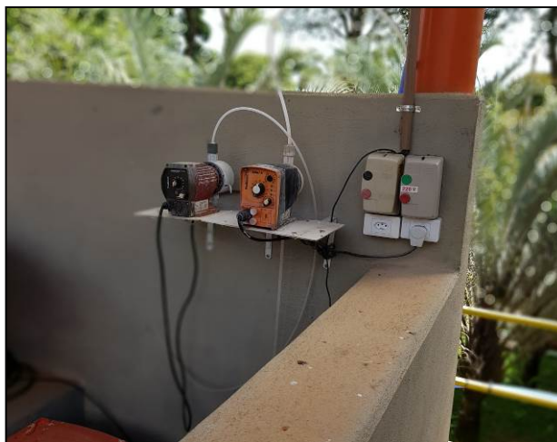
Foto 18 - ETA - Botelhos - Dosagem de ácido fluossilícico
