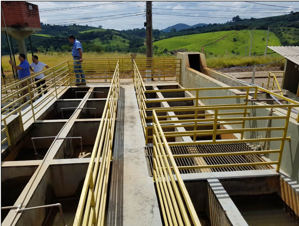
Foto 12 - ETA - Botelhos - Vista dos floculadores
