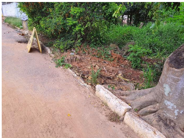
Figura 10 - Meio fio deteriorado compromete direcionamento das águas pluviais.
